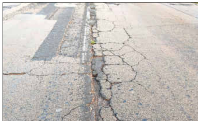
Dringende Erneuerung notwendig!
