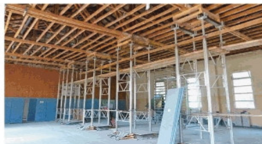
So sieht die Turnhalle im Alten Weiher derzeit aus. Der alte Hallenboden ist abgedeckt, das Dachgebälk für die Sanierung gestützt.
